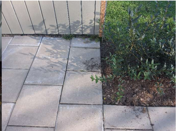
Yttre stenraden kalvar, saknas inspänning
