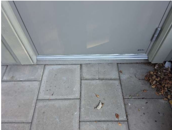
Spricka i marksten
